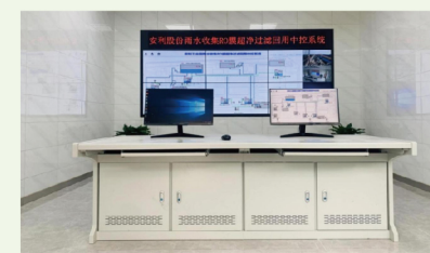
公司雨水收集RO膜超净过滤回用中控系统
