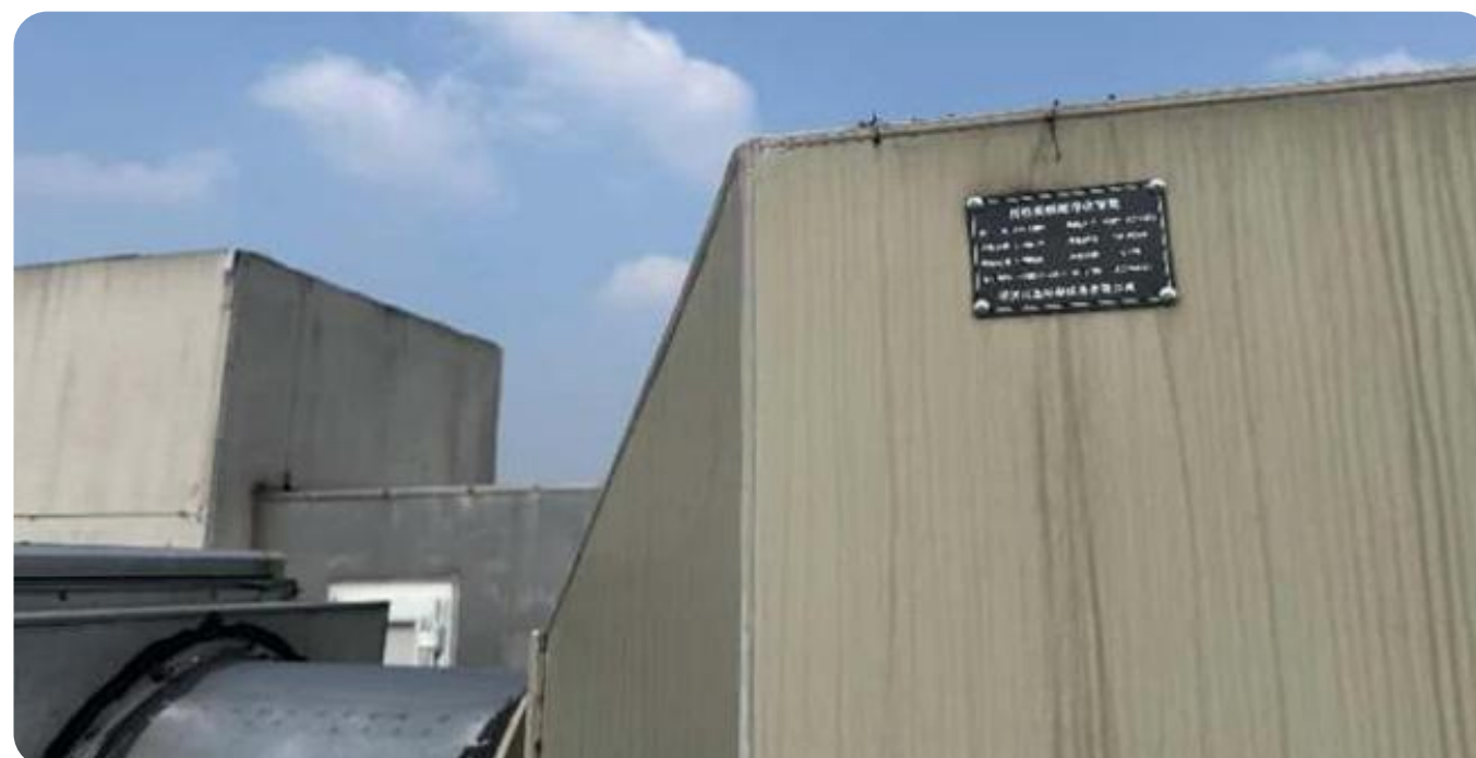
活性炭过滤装置
