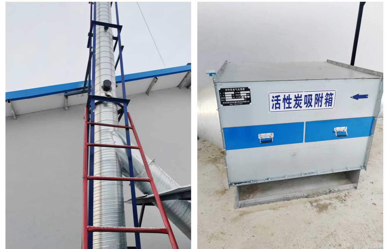
图注：废气检测口和活性炭吸附箱
