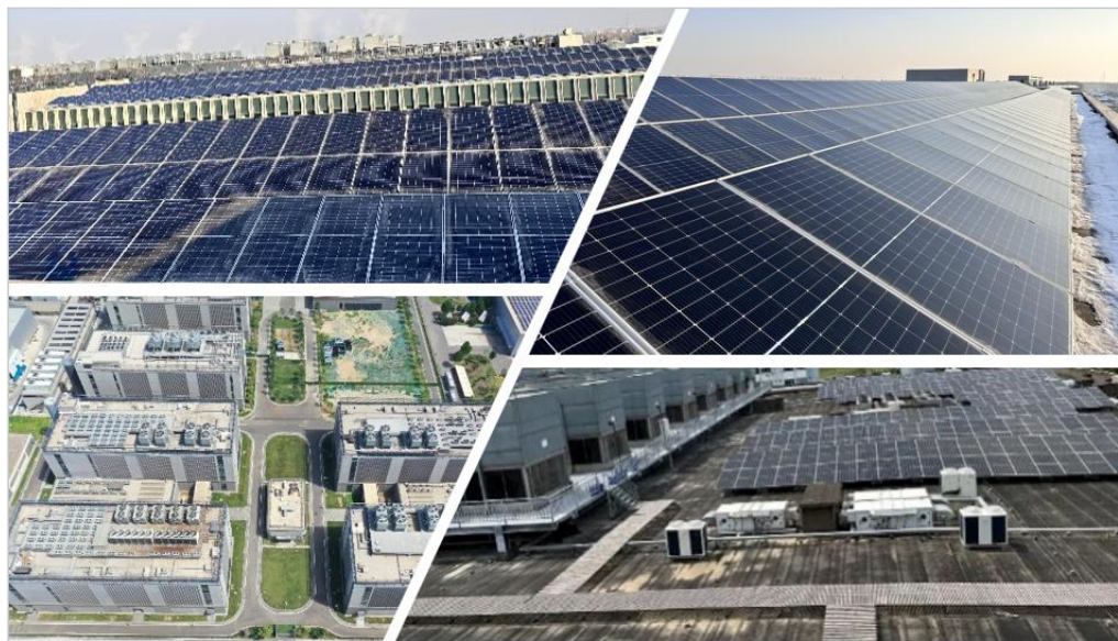
公司投建的光伏系统
