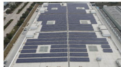
中鼎流体光伏项目（二期）
