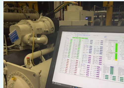
冷水机组智能测试技术应用
