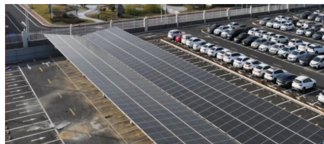
临沂格力光伏项目
