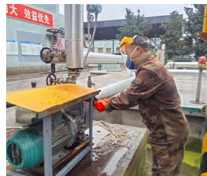
双氧水泄漏事故现场处置方案实战演练
