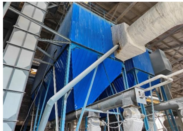
磷铵厂除尘设施
