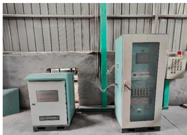
建材厂脱硝设施
