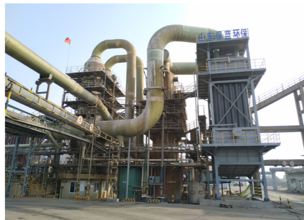
氧化锌厂尾气处理系统
