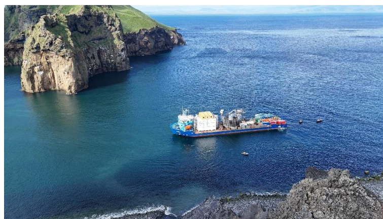
冰岛 VMJ 海缆项目
