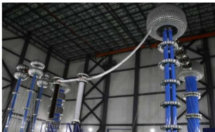
亨通超高压电力测试技术中心
