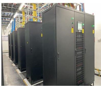
HVDC产品应用于数据中心
